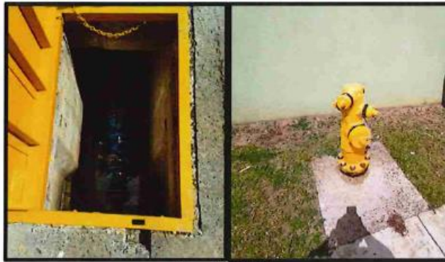
Imagen 4: Válvulas e hidrantes instalados.
