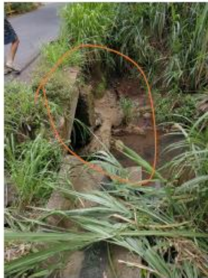
SOCAVACION DE BASTION
