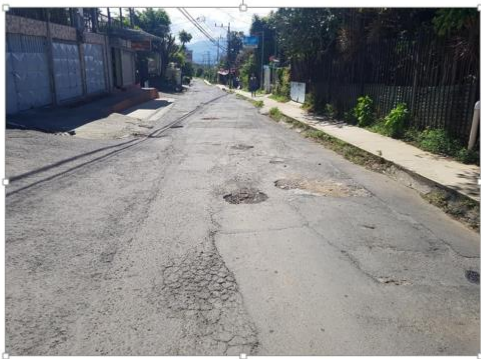
“Imagen #62 – Estado Inicial Calle Montero Jesús”
